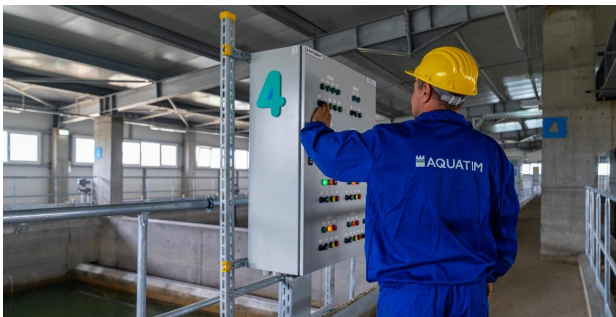
Stația de tratare a apei Bega, Aquatim SA
