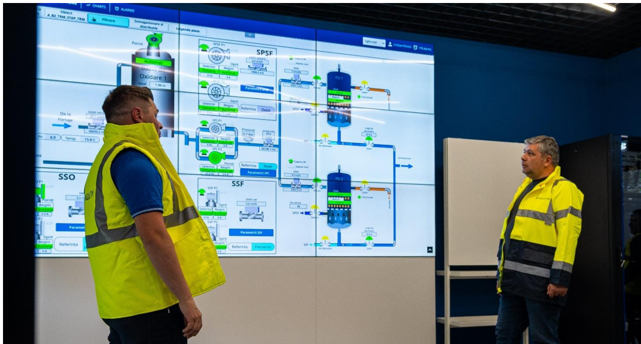
Sistem SCADA regional de monitorizare și control automat al proceselor, Aquatim SA
