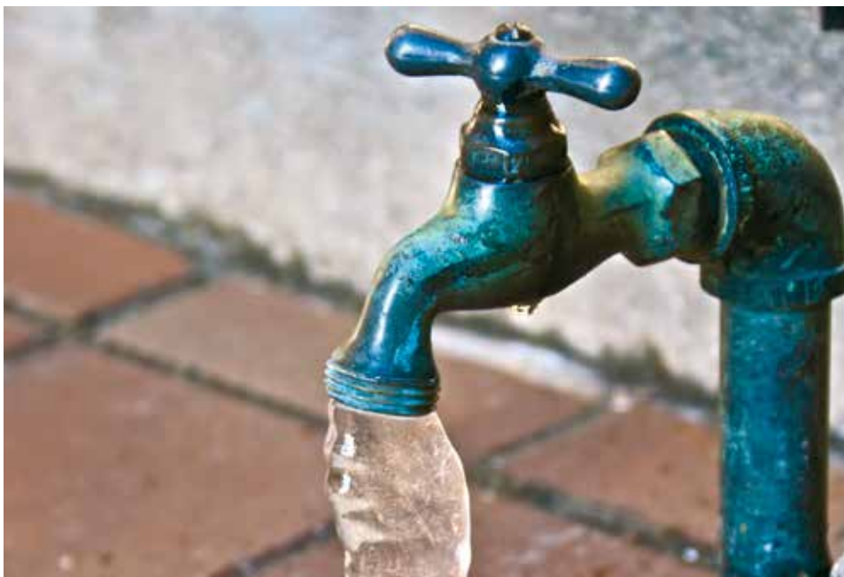
Instalațiile de apă expuse frigului trebuie scoase din funcțiune ori protejate împotriva înghețului. Foto: westchestermagazine.com
